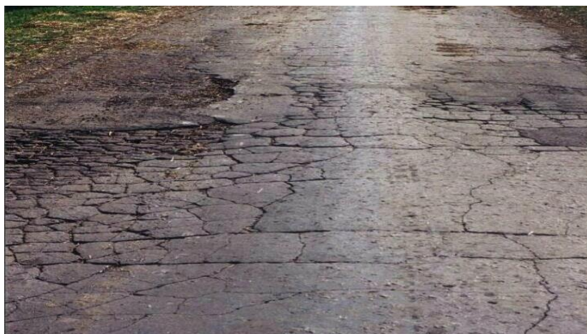
Слика 5.2. - Оштећења коловозног застора
